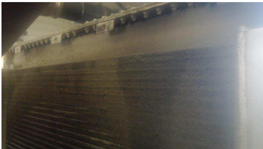
Рисунок 3.1 –Загрязнённый радиатор установленный на двигателе
