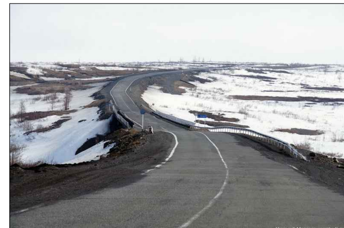
Рис. 6 - Незатухающая термопросадка основания моста
