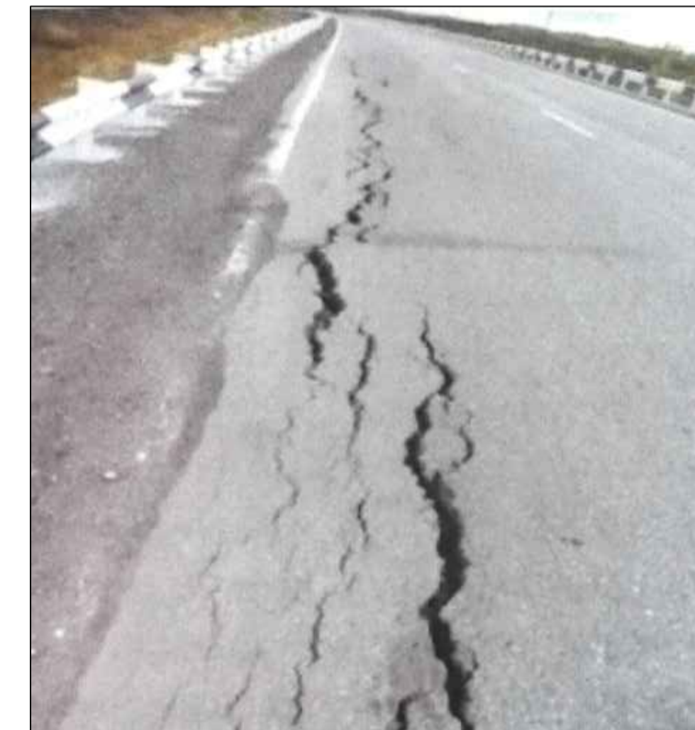
Рис. 7 - Продольная температурная трещина по кромке проезжей части
