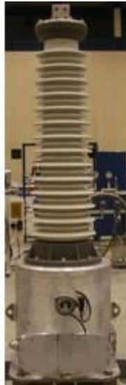
Рисунок 18 – Трансформатор напряжения марки ЗНГ-110 У1
