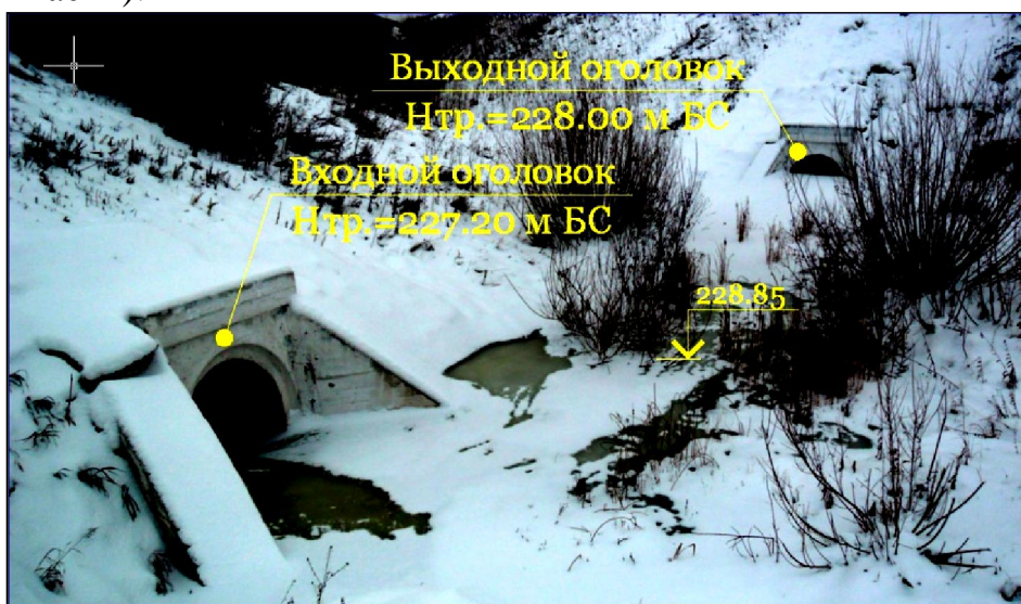
Фото 2. Развитие наледи на участке между трубами
