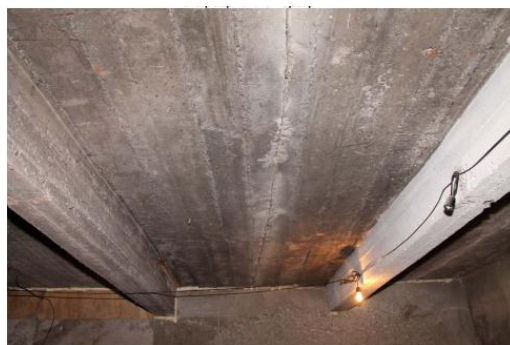
Рисунок 1.4 – Фото пропила плиты в полке в осях (А-В) 1-2
