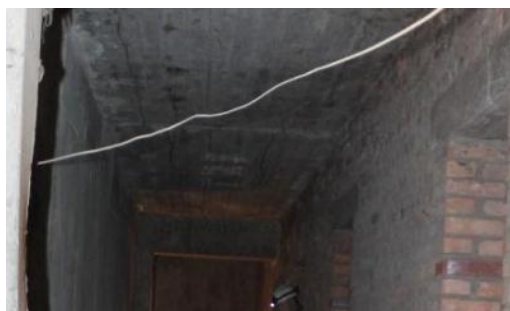
Рисунок 1.3 –фото дефектов находящихся в осях 4/1–8 (А–Б)
