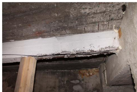
Рисунок 1.1 – Фото балки в осях 1-2 (Б-В)
