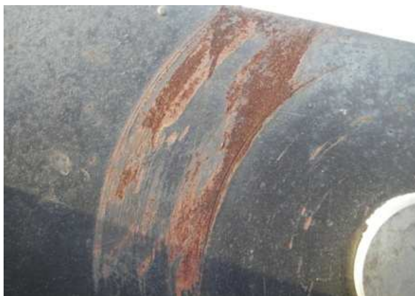
Рисунок 1 – Коррозия на металлоконструкции
