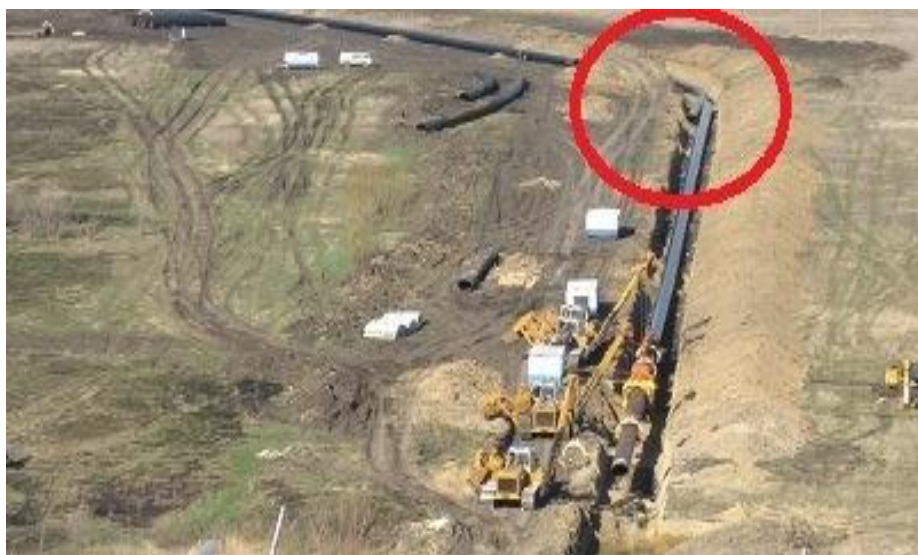
Рисунок 1.4 - Радиус поворота МН на 119,4 км. Кривая поворота МН (при сооружении) со значением угла более 3-х диаметров выделен красным кругом
