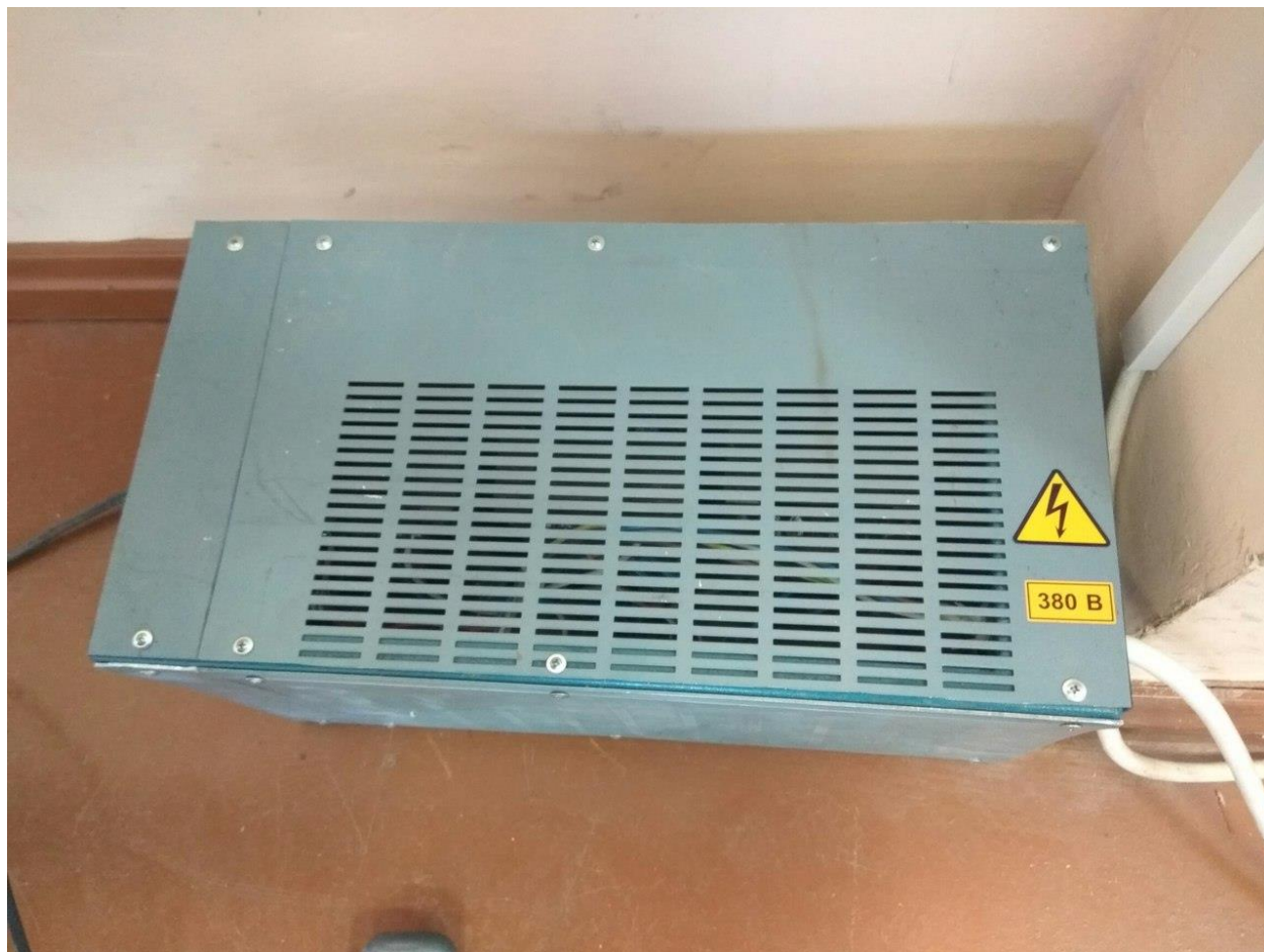
Рисунок 2. 14.Трансформатор помещенный в металлический корпус
