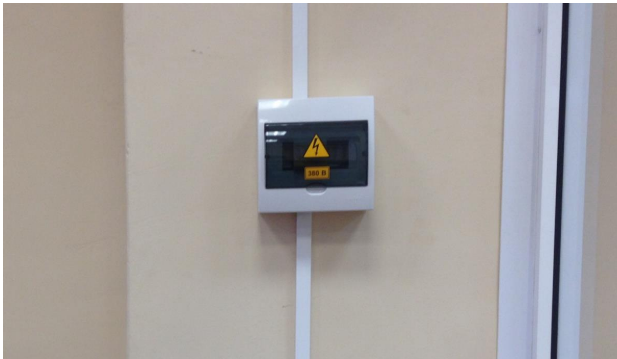
Рисунок 2.6 – Внешний вид распределительного щита в лаборатории по курсу электробезопасность.
