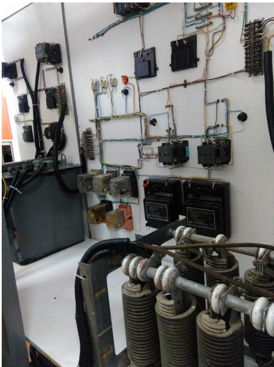
Рисунок 3.2 – внешний вид обратной стороны панели стенда «Исследование режимов работы двухтрансформаторных подстанций»
