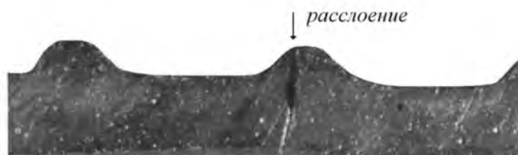
Рисунок 30 - Расслоение продольного сварного шва
