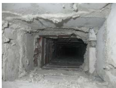
Рис.1 - Результат не правильной работы естественной вытяжной вентиляции в зимнее время года
