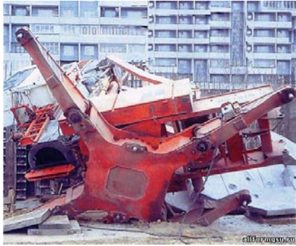
Рис.1 - Авария башенного крана из-за просадки его опорных элементов
