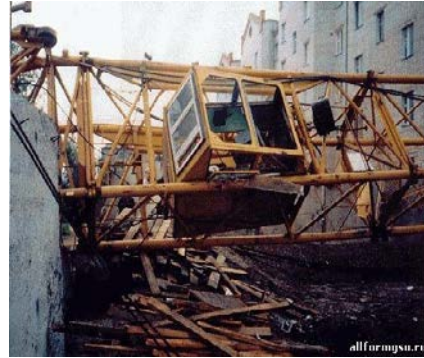
Рис.2 - Аварии башенных кранов, связанных с нарушением правил безопасности работ при их демонтаже
