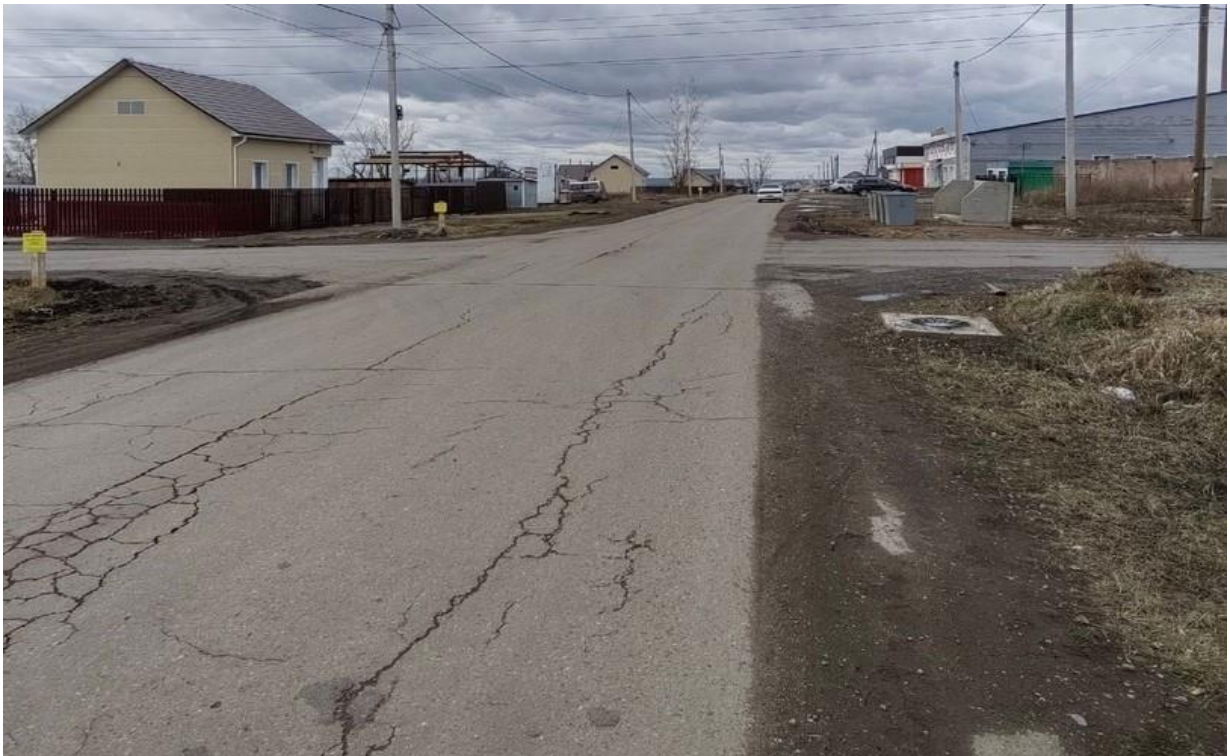
Рисунок 1.18 – Вид состояния проезжей части на пересечении ул. Бограда – ул. Урицкого
