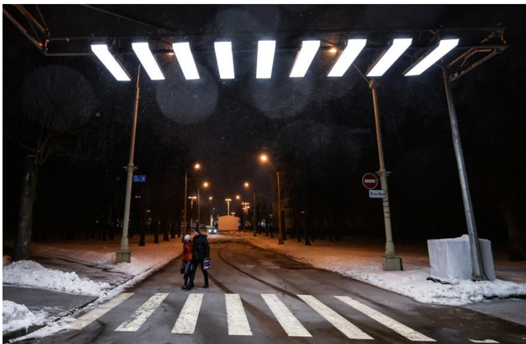
Рисунок 2.1 – Светодиодные светильники над проезжей частью
