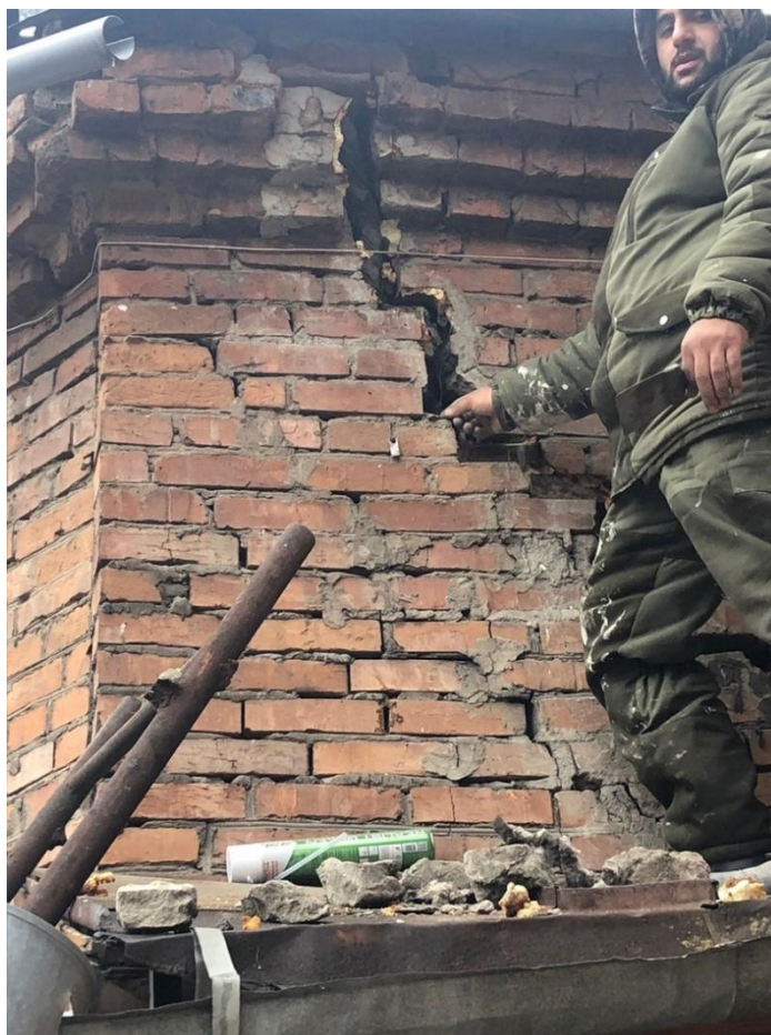
Рис. 3.2.1 - трещина на северном фасаде
