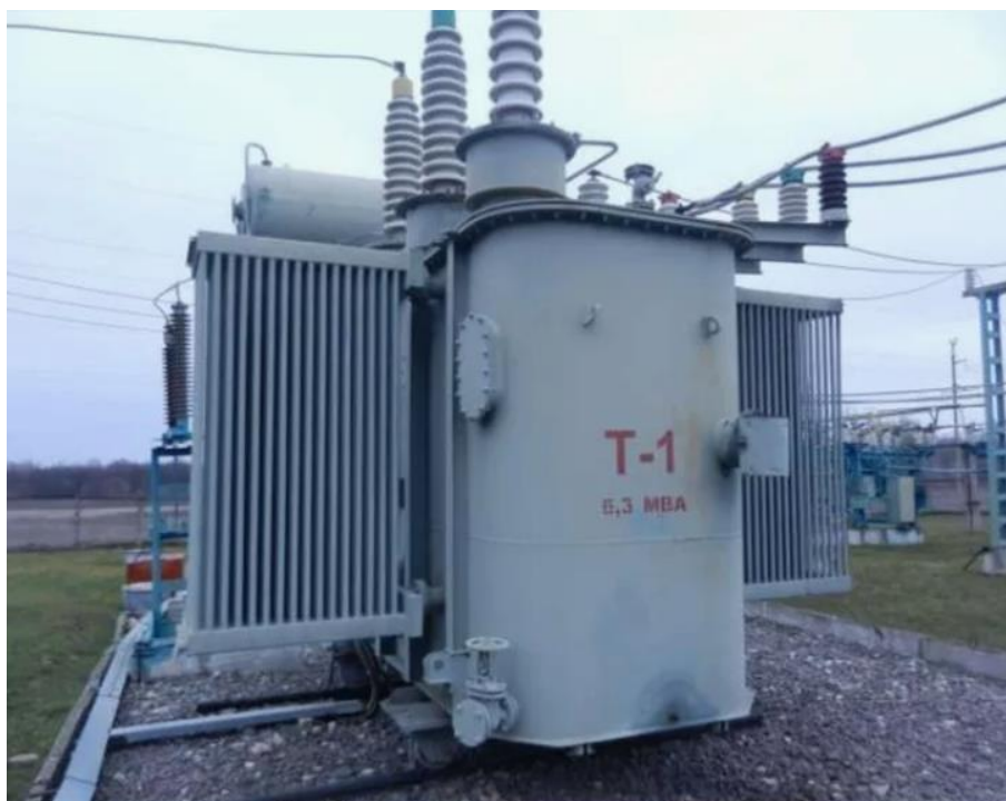
Рисунок 1.2 – Общий вид существующего трансформатора Т-1 подстанции типа ТМН-6300/110
