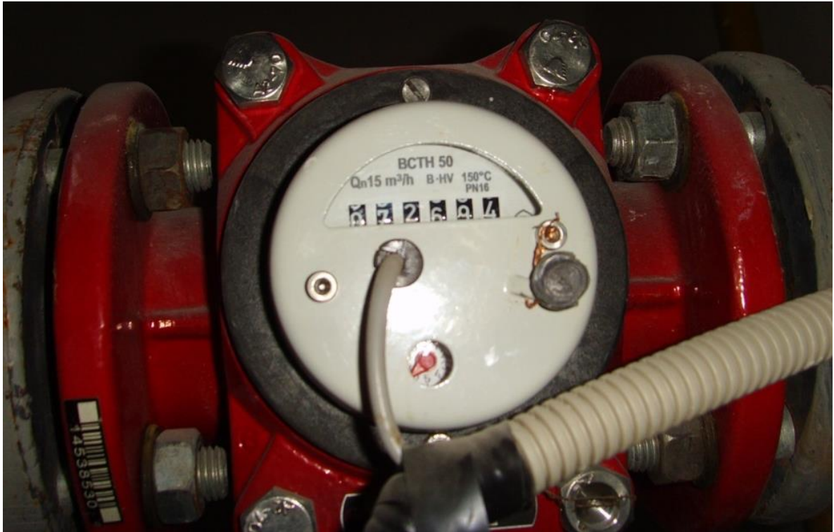
А) Расходомер ВСТН Ду50 контура системы отопления
