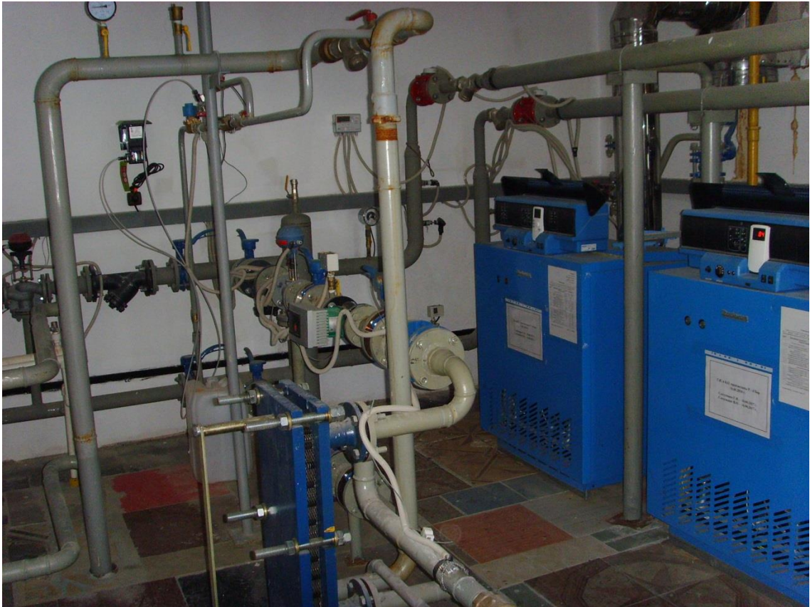
А) водогрейные котлы контура горячего водоснабжения
