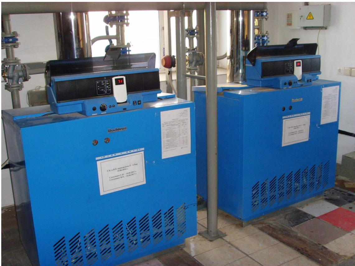
Б) водогрейные котлы контура системы отопления
