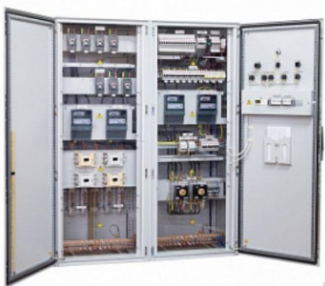
Рисунок 6 — Шкаф вводно-распределительного устройства
