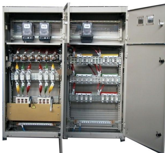
Рисунок 3.10 — Разделительные панели вводно-распределительного устройства
