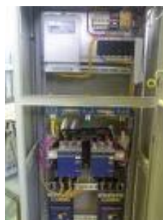
Рисунок 3.9 — Шкаф вводно-распределительного устройства
