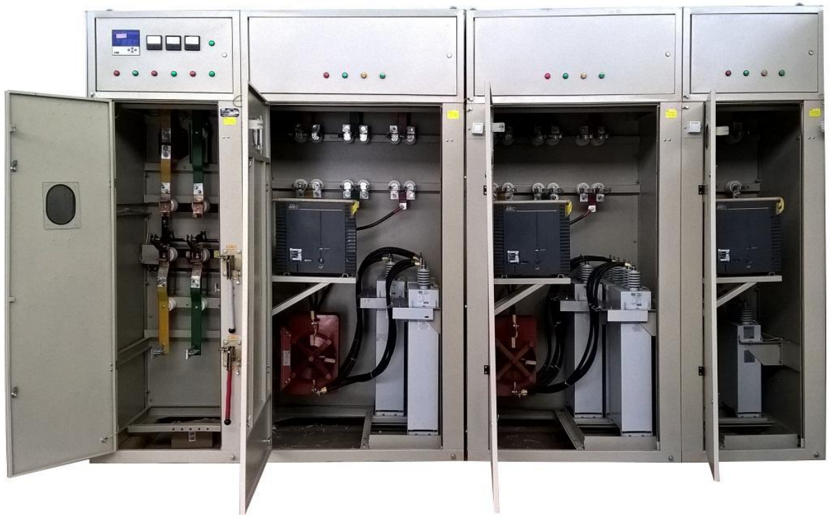
Рисунок 5 – Конденсаторные батареи УК56-10,5
