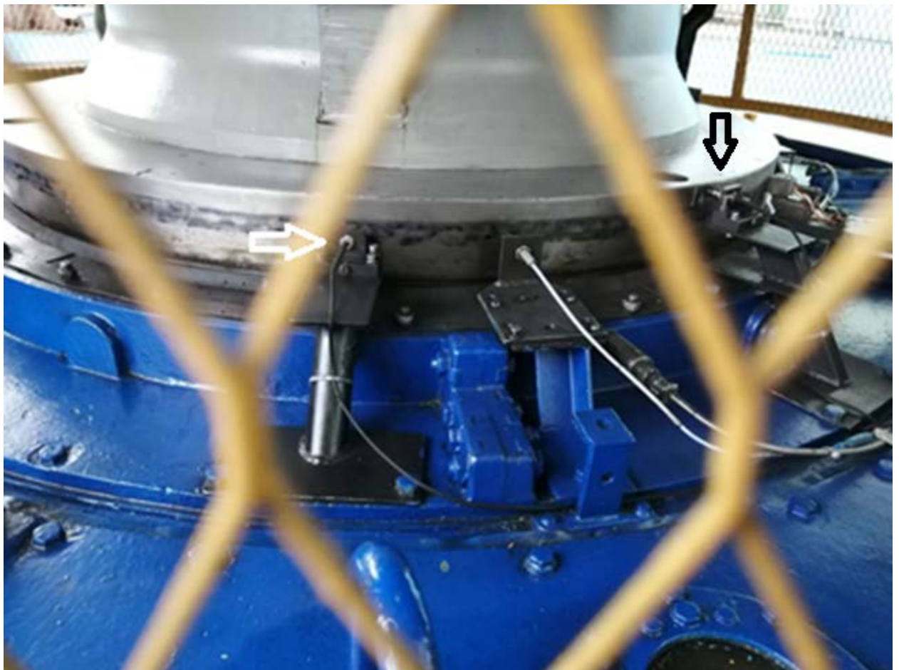
Рисунок 10.14 – Датчики: бой вала (белая стрелка), отметчик оборотов (черная стрелка) в районе генераторного подшипника
