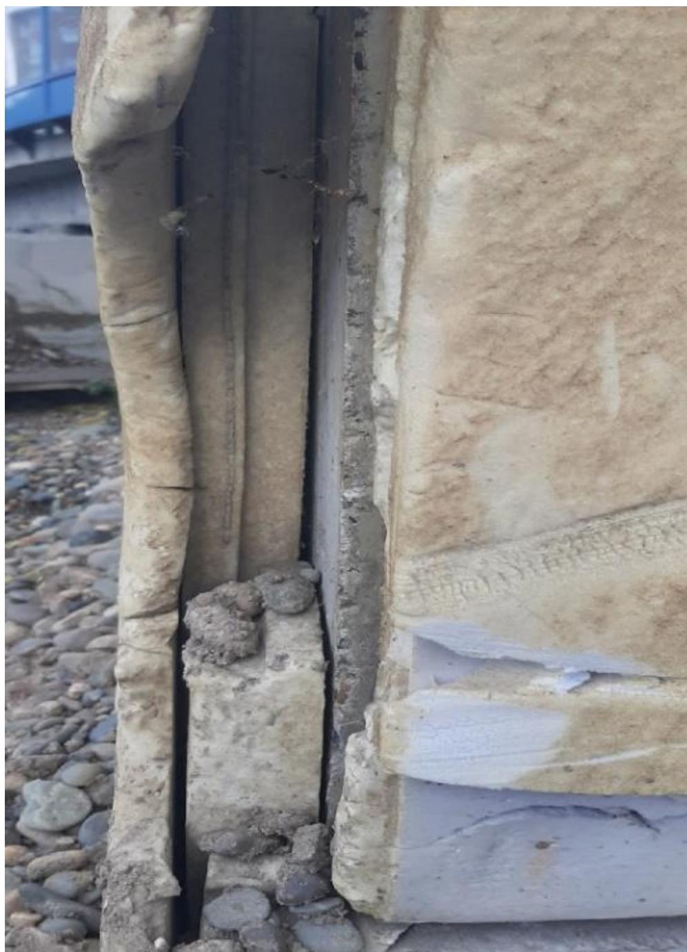
Рисунок 2 – Пример нарушения технологии крепления слоя утеплителя к несущему слою стены цоколя в здание по адресу г. Абакан, ул.
