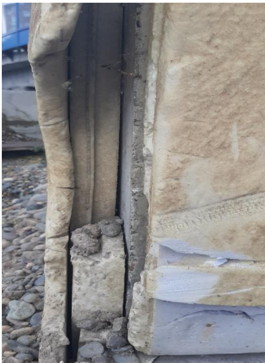
Рисунок 1 – Пример распространенной ошибки при монтаже утеплителя
