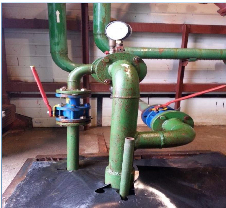
Рисунок 1.6 – Типовой оборудование оголовка эксплуатационных скважин
