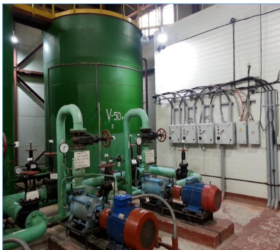
Рисунок 1.8 – Насосная станция II подъема Широкинского водозабора и установка для аэрации воды.
