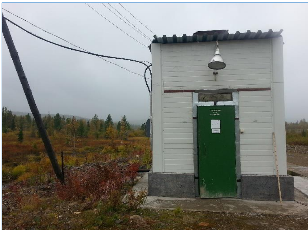
Рисунок 1.5 – Типовой павильон, установленный над эксплуатационными скважинами
