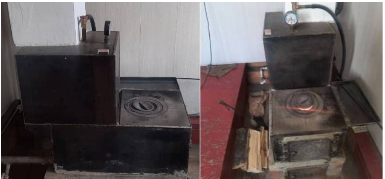
Рисунок 28 – Общий вид твердотопливного котла
