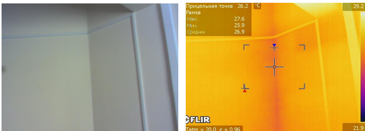
Рисунок 3.4 – Фрагмент углового сопряжения и термография тупого угла
