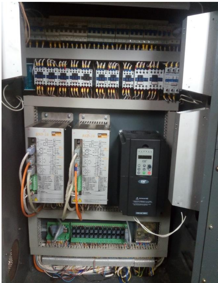
Рис.10. Новый шкаф электроавтоматики станка
