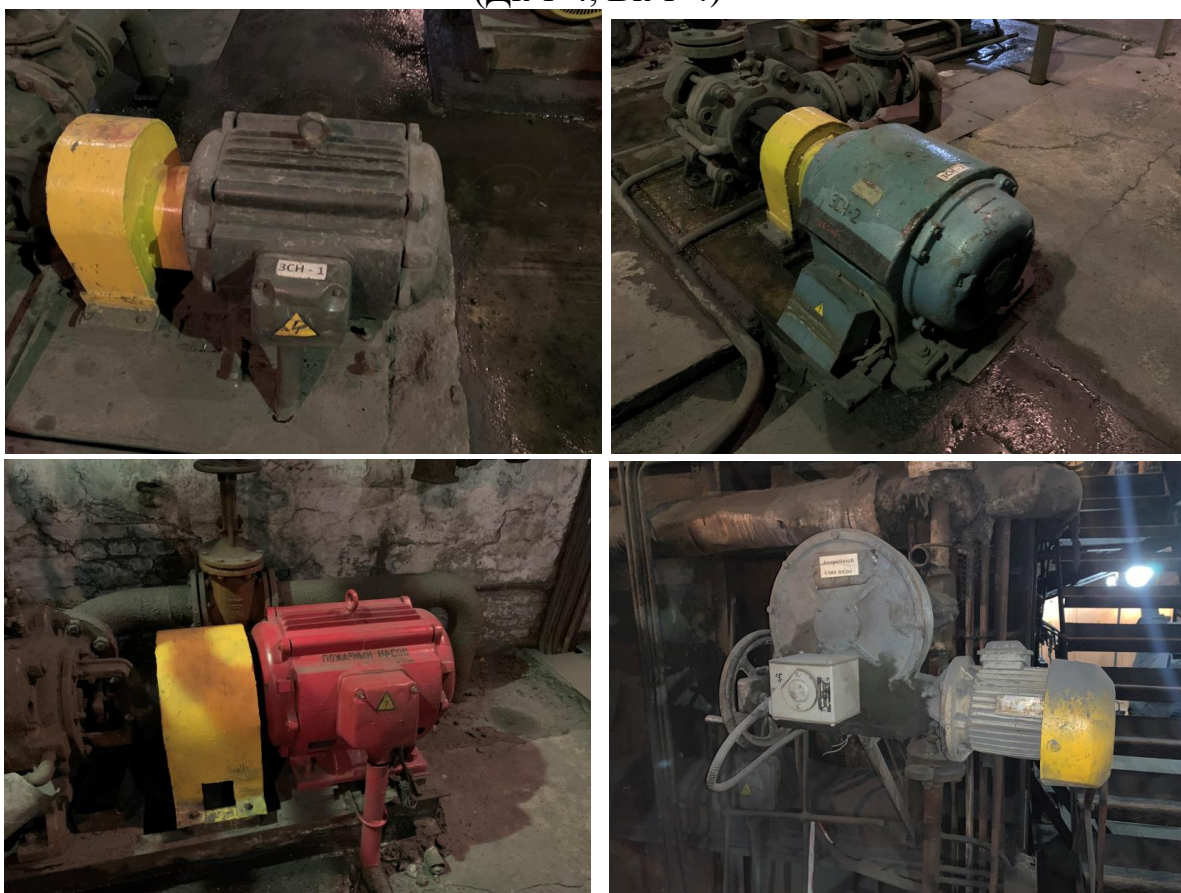
Рисунок 2.4 – Электродвигатели ЗСН, пожарного насоса, насоса аварийного слива воды
