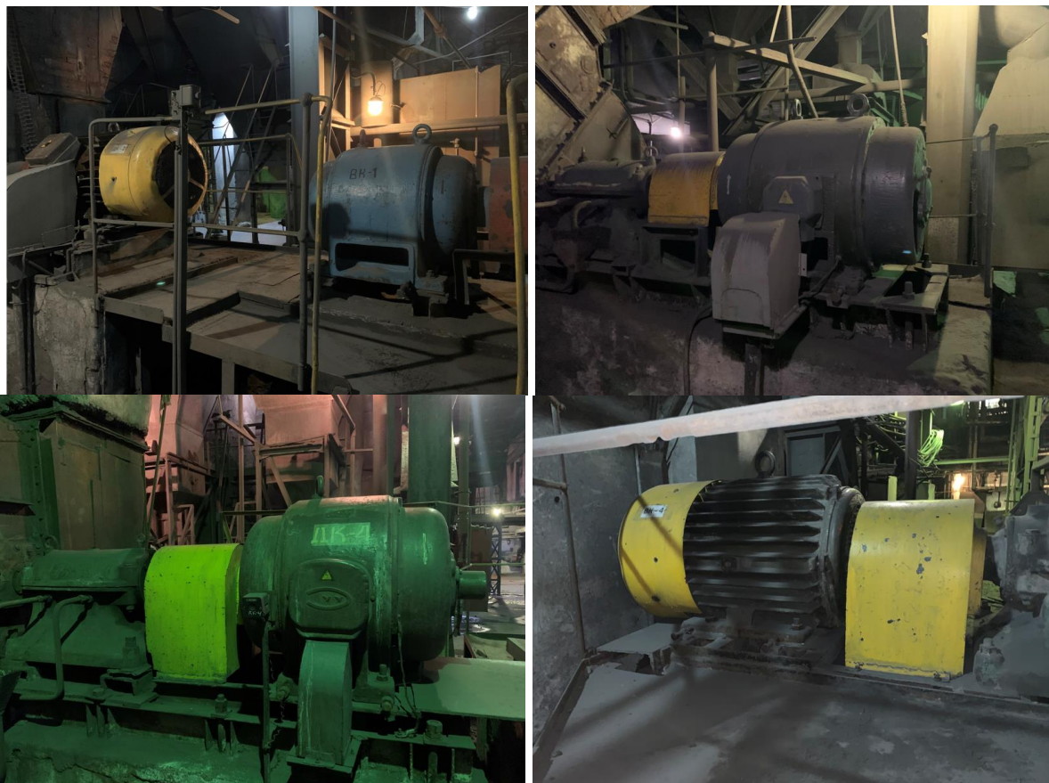
Рисунок 2.3 – Электродвигатели дымососов и вентиляторов котлов (Дк 1-4, Вк 1-4)
