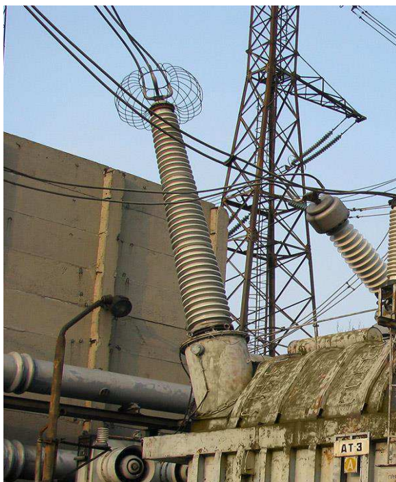
Рисунок 10.3 – Высоковольтный ввод силового трансформатора 500 кВ
