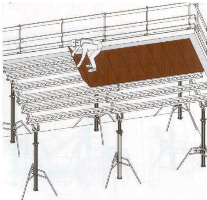
Рисунок 5.9 - Укладка листов фанеры: 1-поперечная балка; 2-укладываемый щит; 3-уложенный и закрепленный щит; 4-ограждение по периметру возводимого перекрытия
