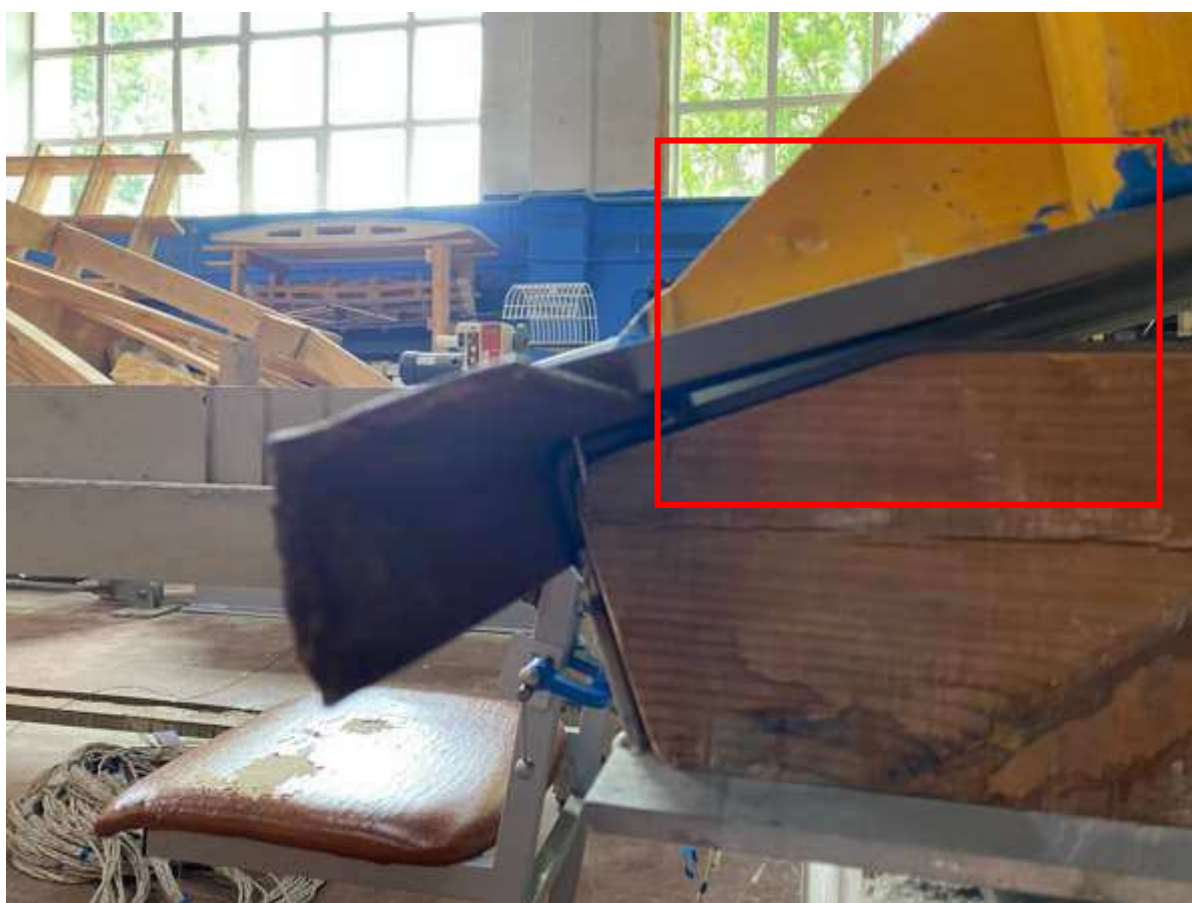
Рисунок 4.16 – Деформации возникшие в конструкции;
