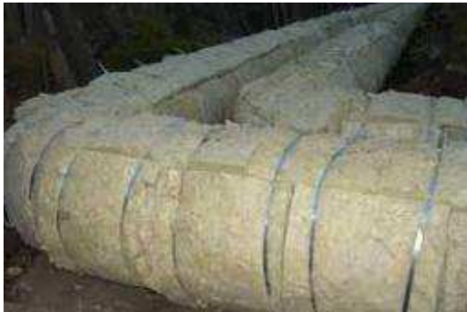
Рисунок 9 - Трубы теплосети с теплоизоляцией из минеральной ваты
