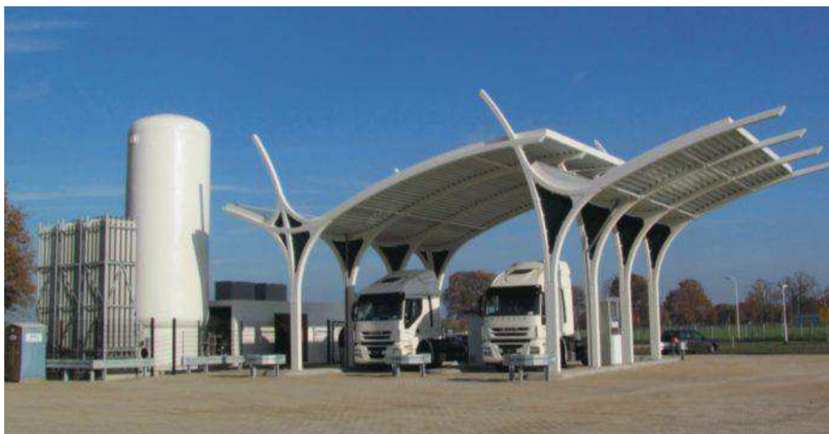
Рисунок 7- заправочная станция СПГ
