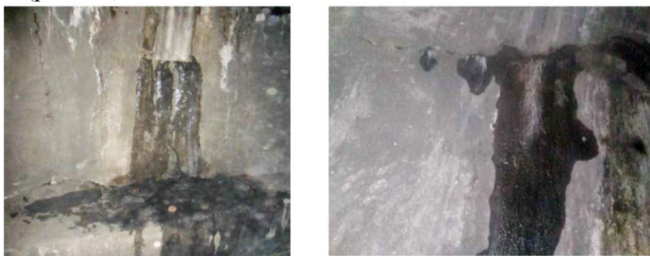
Рисунок 2 – Наледообразование и сосульки в середине тоннеля «Истиклол»
