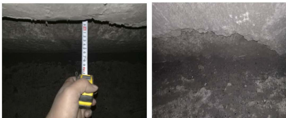
Рисунок 3 – Раковины в обделке тоннеля «Истиклол»
