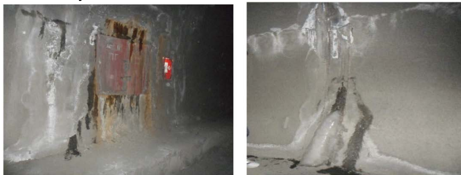
Рисунок 4- Последствие влияния инфильтрационных вод в тоннеле «Шахристан»
