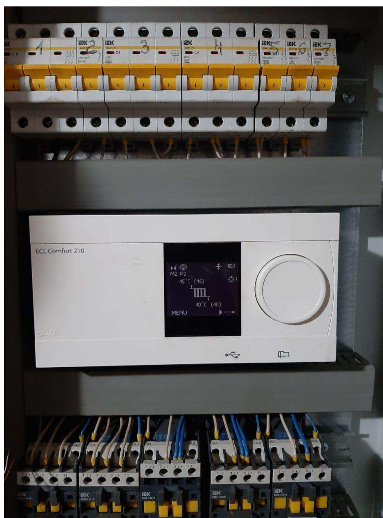
Рисунок 8 – Электронный регулятор ECL Comfort 210 (внутренний контур системы теплоснабжения)
