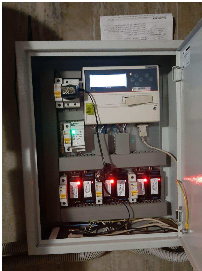
Рисунок 9 – Шкаф автоматизации наружной теплосети ввод в жилое здание
