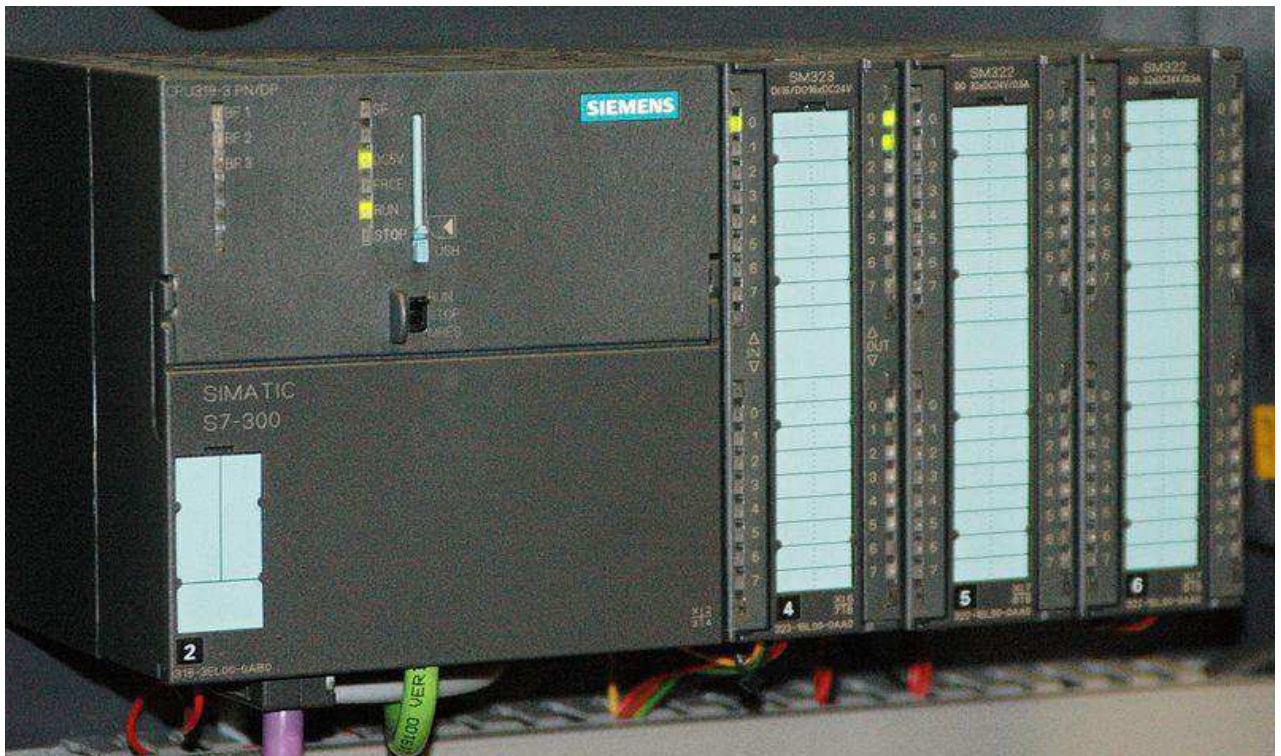
Рисунок 2.4 – Контроллер Simatic S7-300
