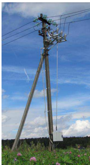
Рисунок 3.12 – Опора ВЛ 10 кВ с УПС
