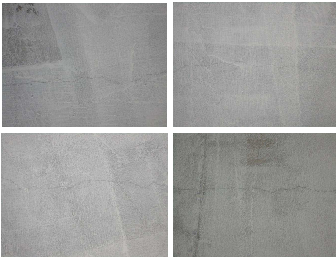
Рисунок 3.12 - Трещины снизу плиты на последнем этапе нагружения 736 кг/м 2
