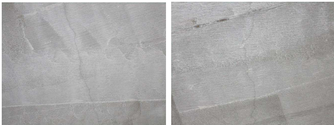
Рисунок 3.11 - Трещины снизу плиты до начала испытания
