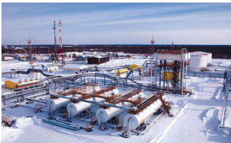
Рисунок 3 – Дожимная насосная станция
