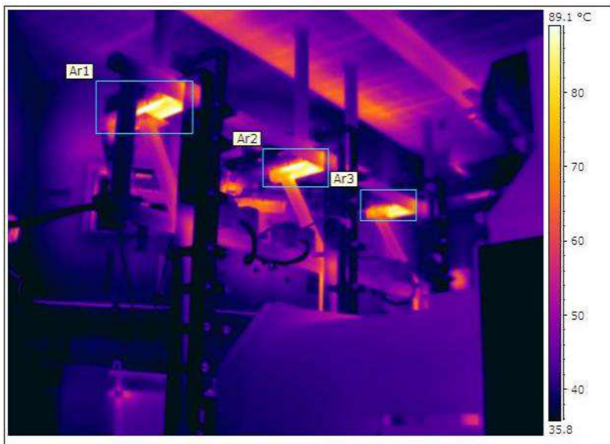
Рисунок 10.6 - Камера главных выводов
