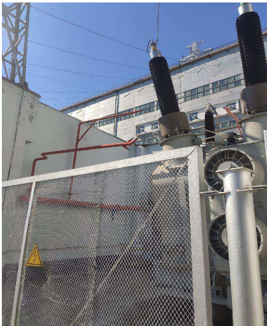
Рисунок 9.8 – Дренажные оросители на силовом трансформаторе.
