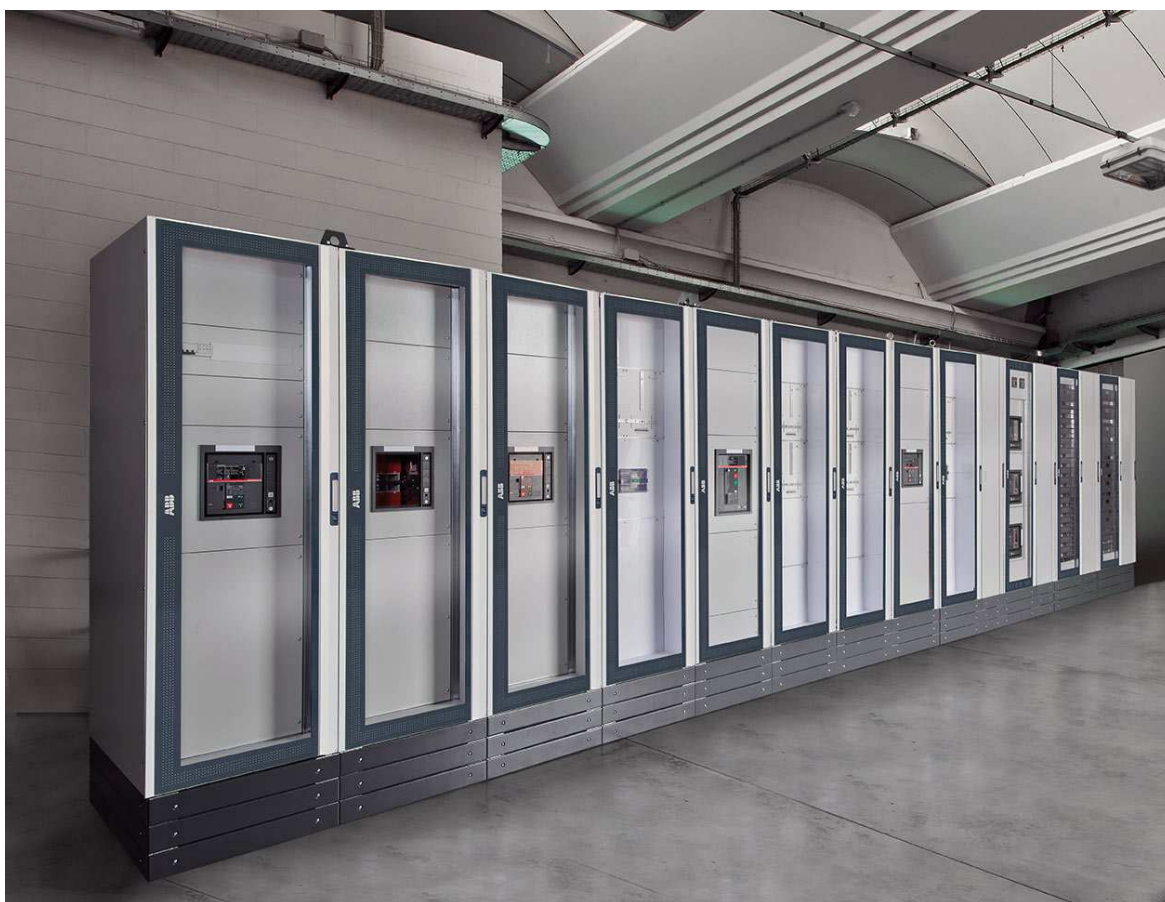
Рисунок 9.1 – шкафы АВВ с терминалами Е-МАХ
