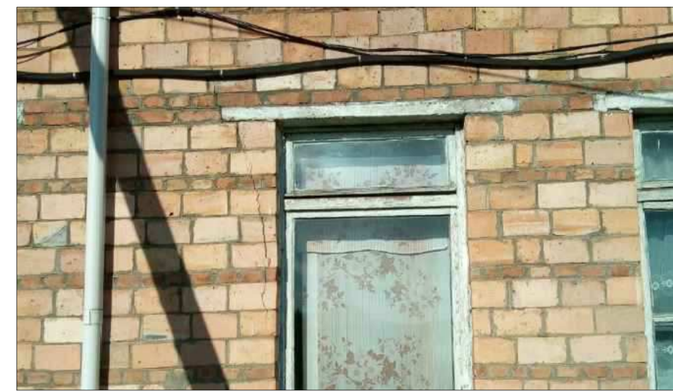
Трещина на фасаде в осях В/4-5
