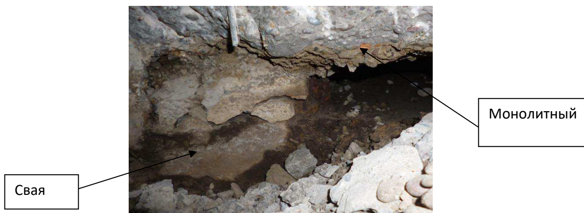
Рисунок 2.2 - Разрушение бетона сваи в осях Е/6
