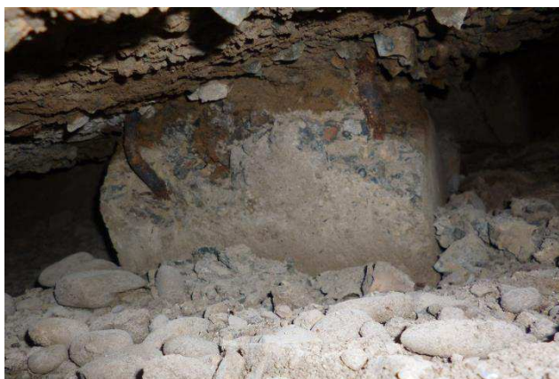
Рисунок 2.3 - Деформация рабочей арматуры сваи в месте заделки в ростверк
