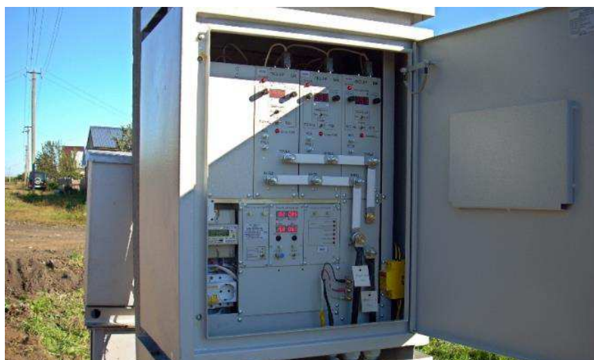
Рисунок 5 – Станция катодной защиты (СКЗ)
