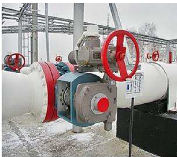
Рисунок7 – Узел регулирования на открытой площадке без укрытия
