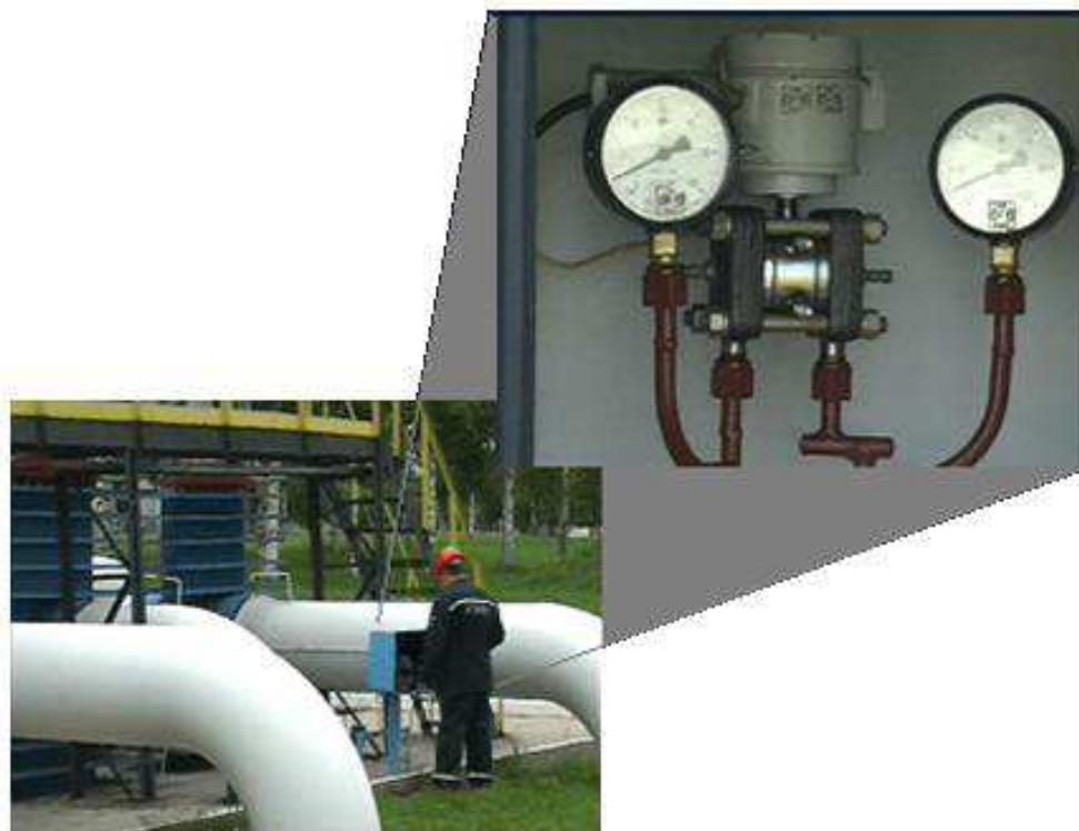
Рисунок 6 – Блок манометров для контроля перепадов давления в фильтре-грязеуловителе
