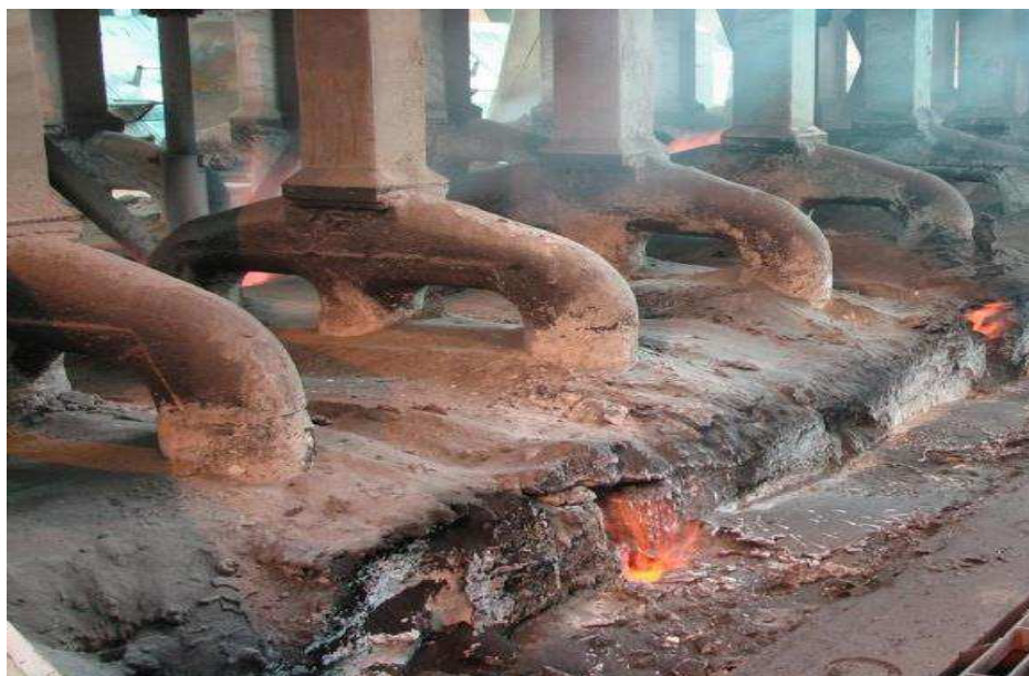
Рисунок 12 – Нарушение целостности укрытия анодного массива, приводящее к дестабилизации работы электролизной ванны
