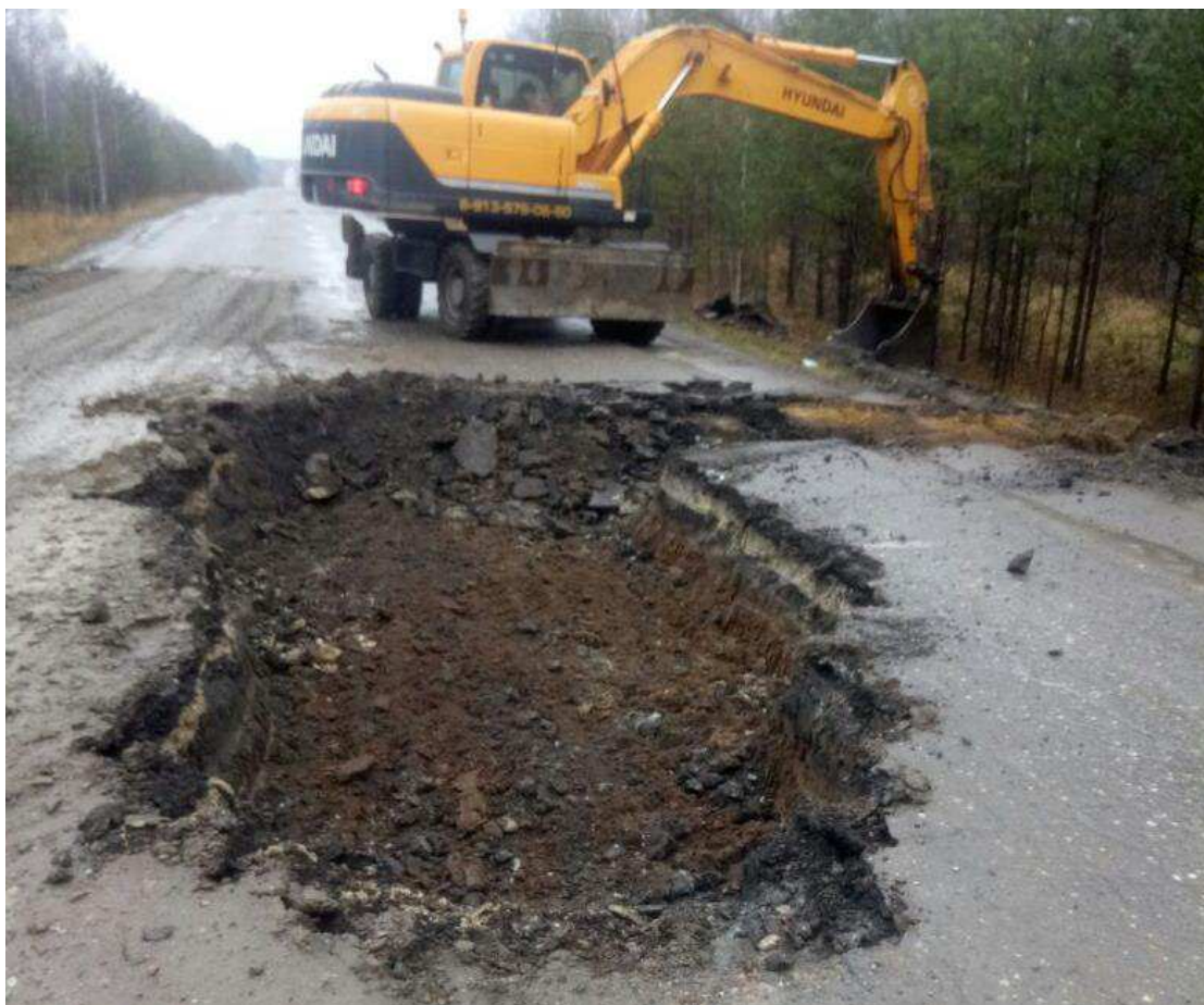
Рисунок 17 – Слабые грунты в земляном полотне автомобильной дороги
