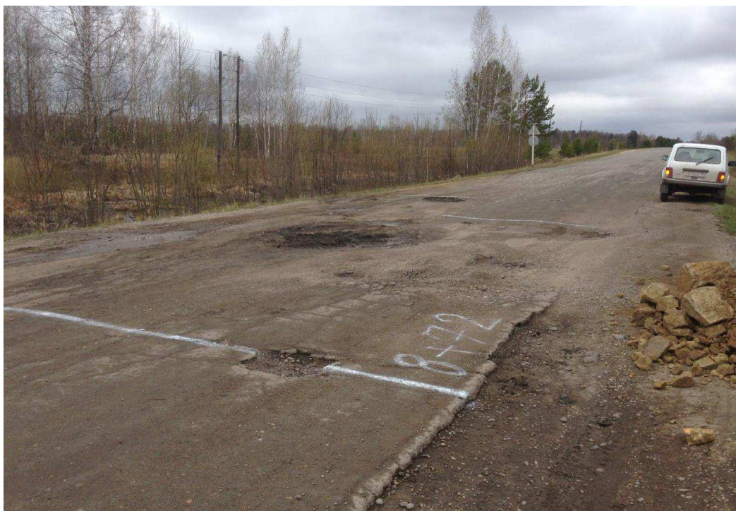
Рисунок 15 – Деформации покрытия автомобильной дороги из-за потери прочности слабого грунта в земляном полотне
