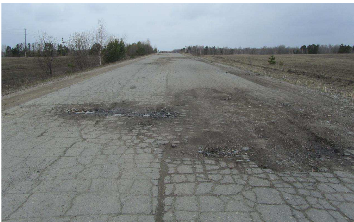
Рисунок 16 – а/д «Енисейск – Пировское» - Деформации покрытия автомобильной дороги из-за потери прочности слабого грунта в земляном полотне
