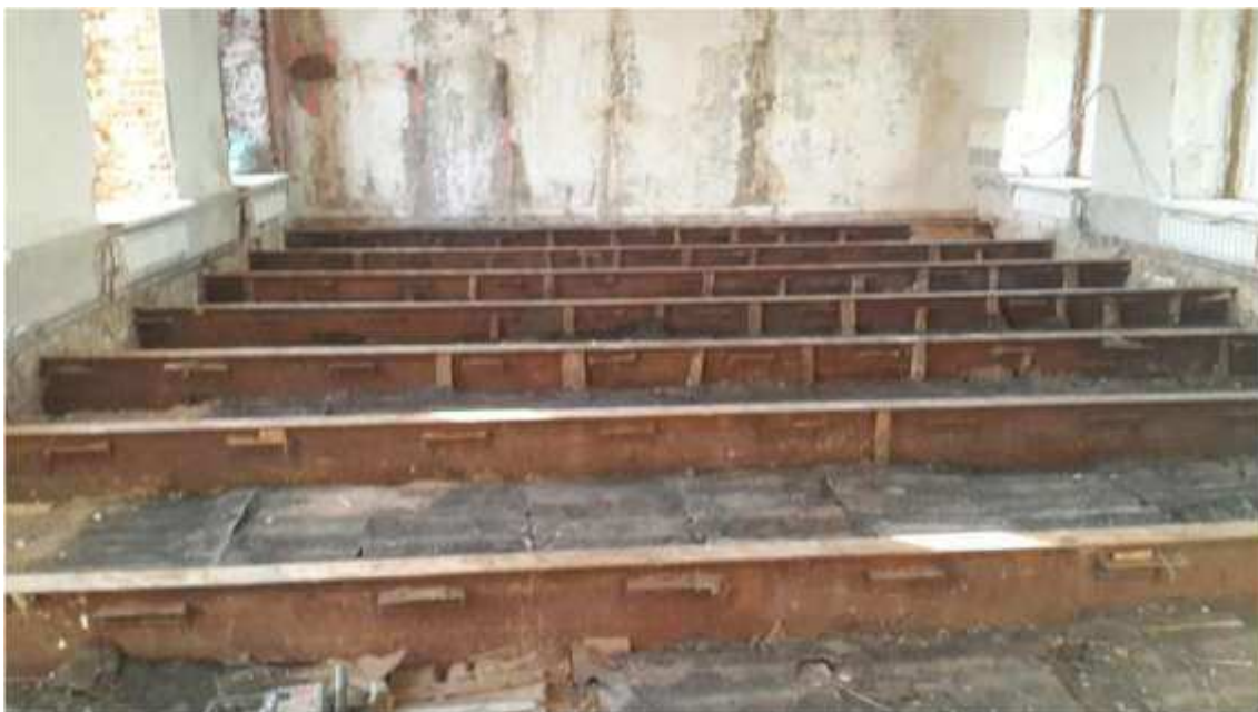
Рисунок 3.1 – Вид перекрытия над 1-м этажом, коррозия стальных балок.
