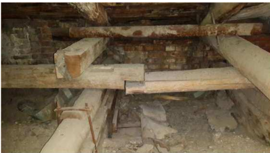
Рисунок 3.10 – Расстройство узлов стропильной системы
