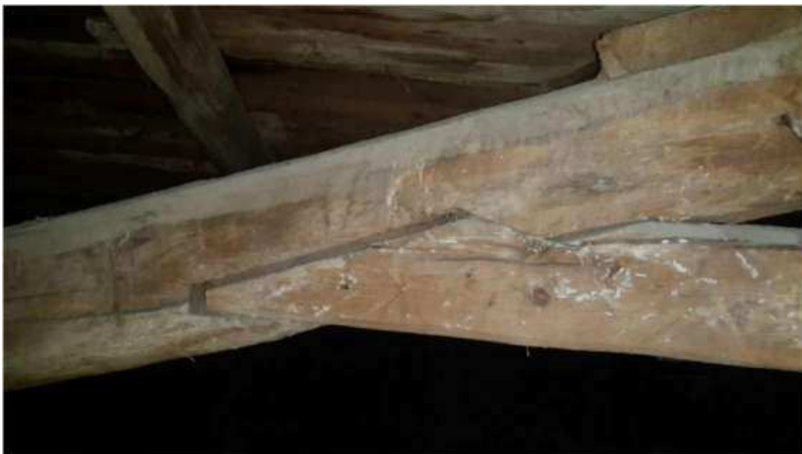
Рисунок 3.7 – Расстройство узлов стропильной системы
