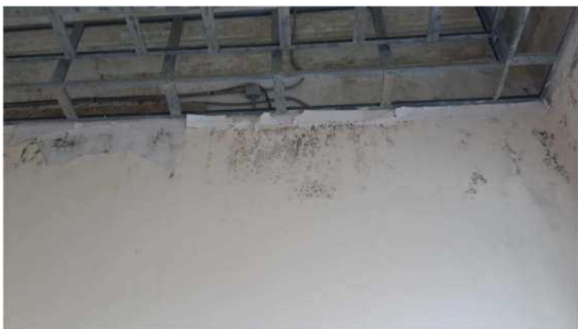
Рисунок 3.4 – Плесень на стенах и перекрытиях.
