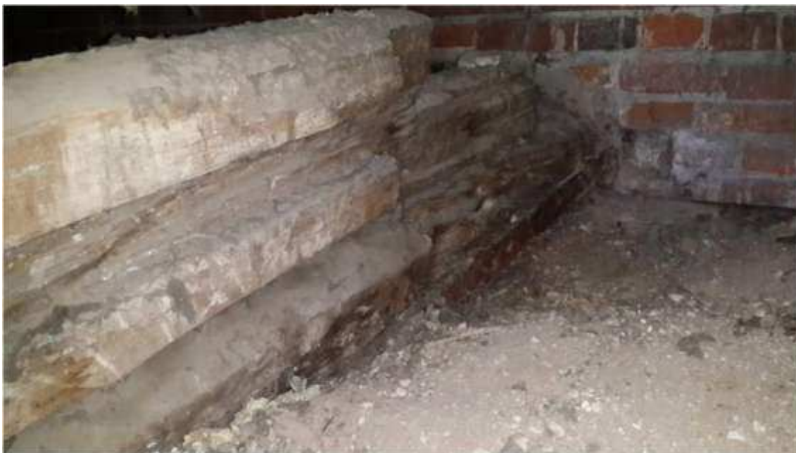
Рисунок 3.5 – Гниль опорных концов деревянных балок чердачного перекрытия.
