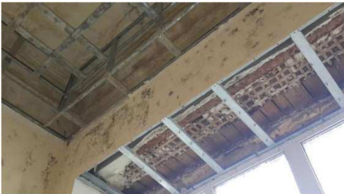
Рисунок 3.3 – Разрушение надоконной перемычки.
