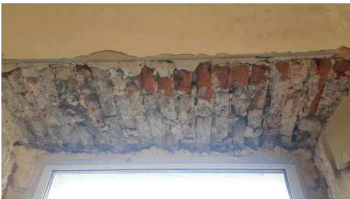
Рисунок 3.2 – Разрушение кирпичной кладки клинчатой перемычки.
