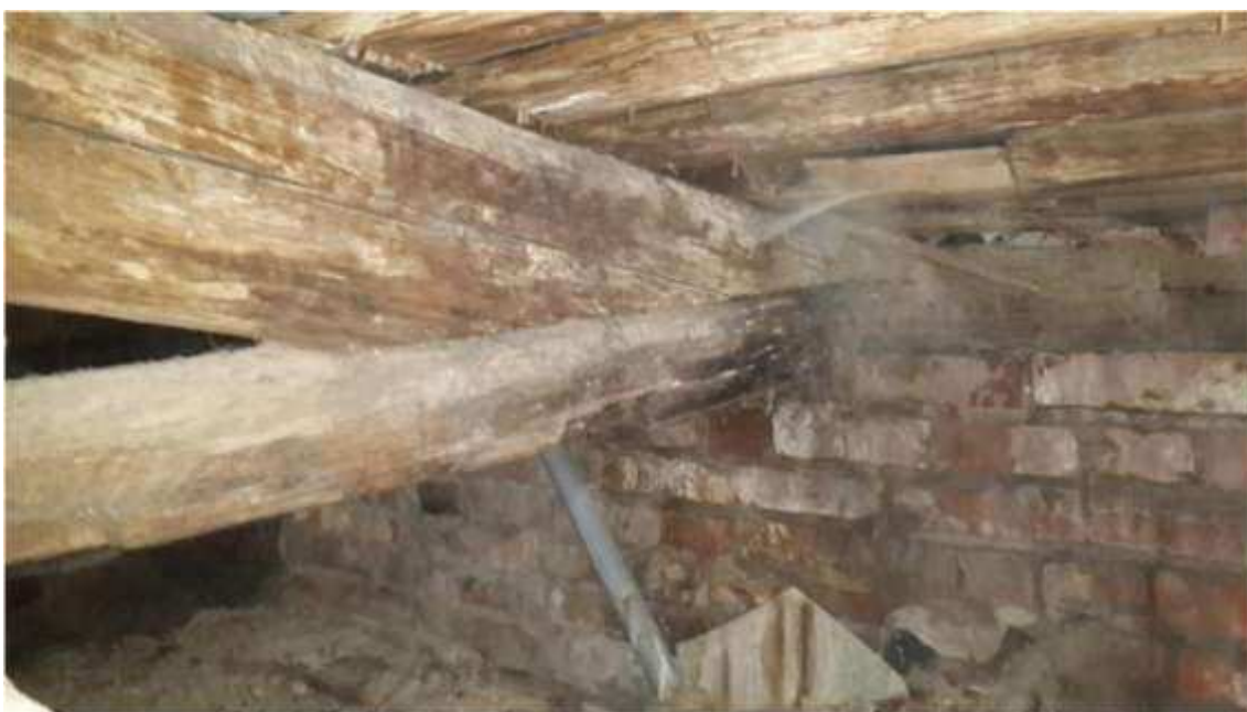
Рисунок 3.6 – Гниль опорных концов стропильных ног и мауэрлата.
