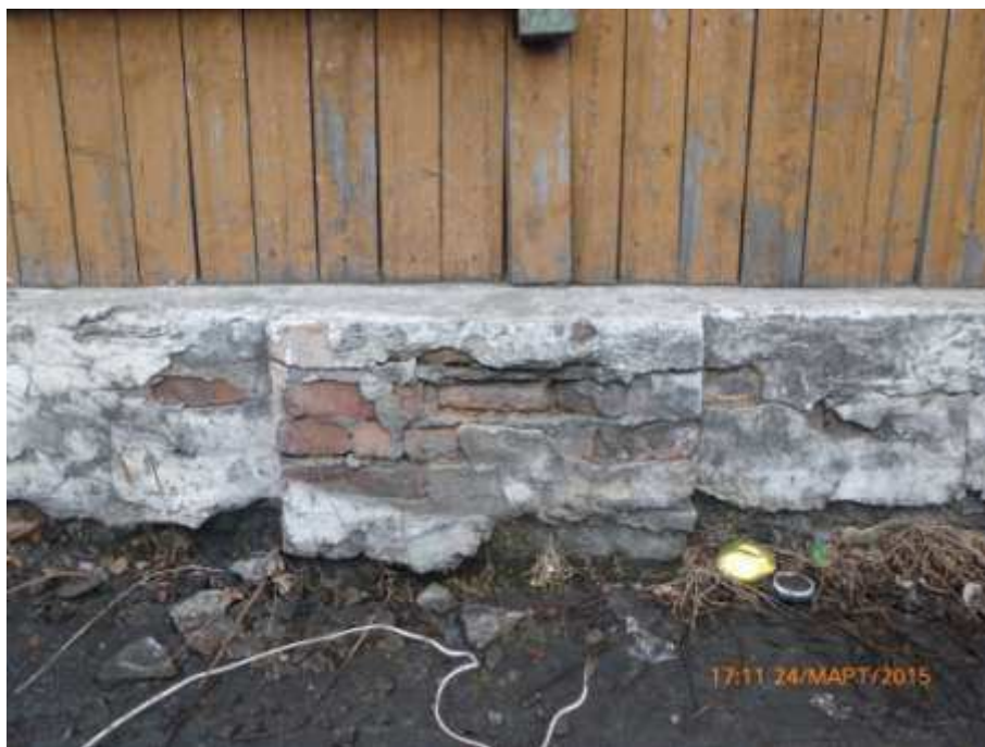
Рисунок 4.3.6 – Дефекты фундамента и отмостки здания.
