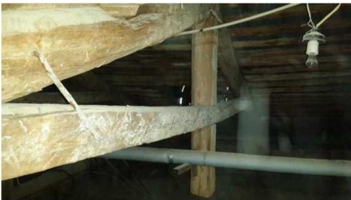
Рисунок 3.8 – Прогиб стропильной системы
