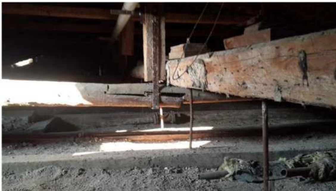
Рисунок 3.9 – Разрыв затяжки, искривление подвесов стропильной системы.
