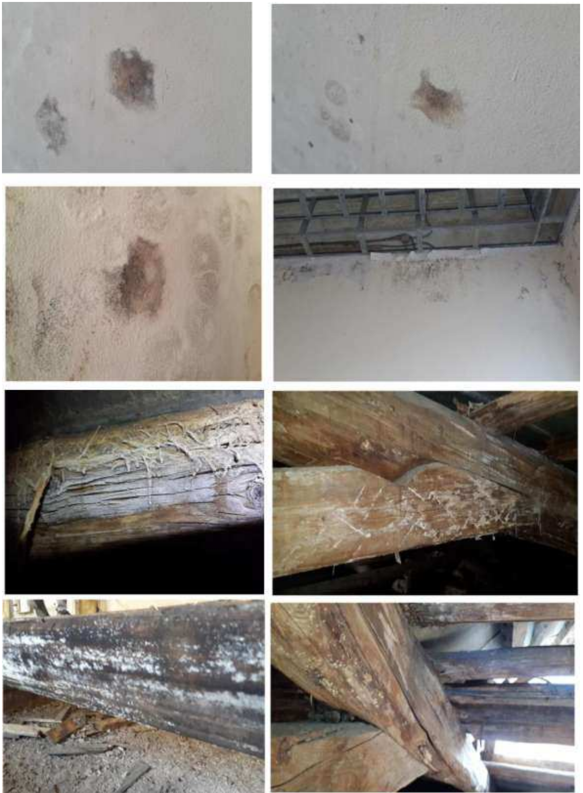
Рисунок 3.11 – Следы биоповреждения древесины и развития плесени на поверхности штукатурки
