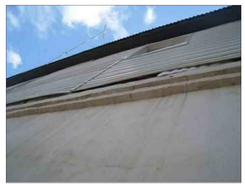
Наличие потеков, образующихся вследствие замачивания кирпичного пояса атмосферными осадками
