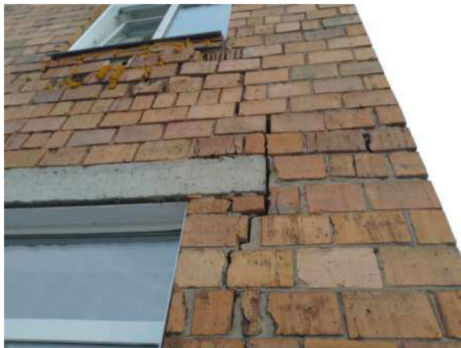
Рисунок 6.6 - Трещины в несущих конструкциях стен здания Мировых судей
