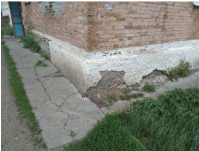
Рисунок 6.3 - Дефекты отмостки многоквартирного жилого дома
