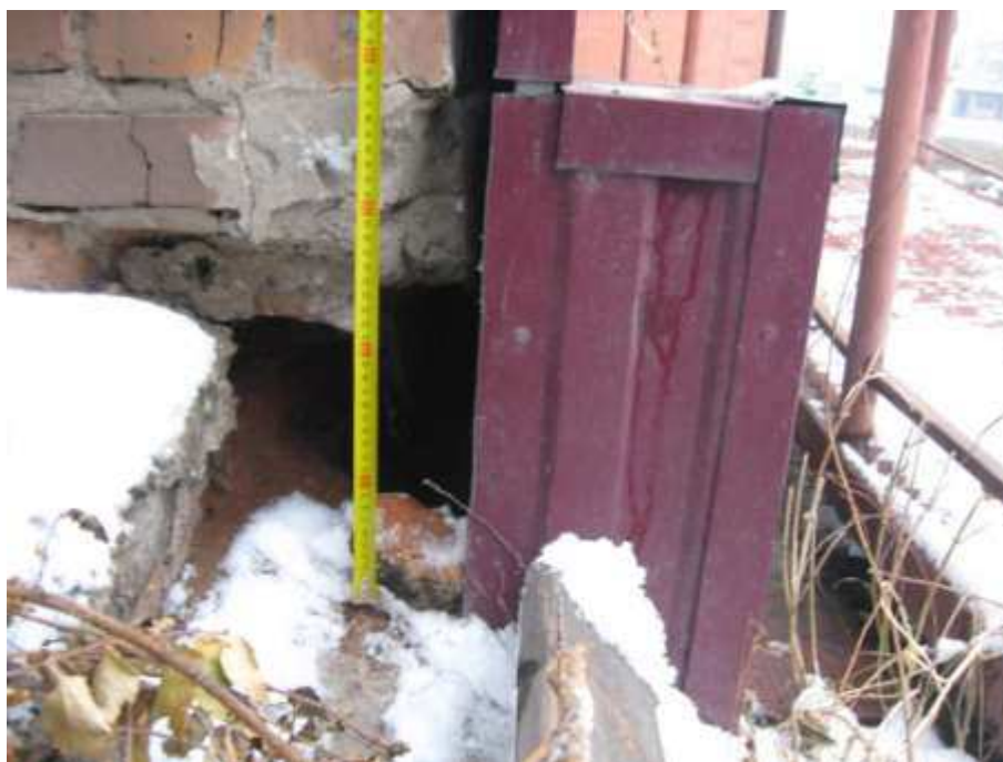
Рисунок 6.8 - Дефекты основания здания Мирowych судей
