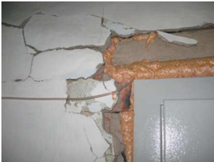
Рисунок 6.10 - Деформация дверных блоков, промерзание ограждающих конструкций здания Мировых судей
