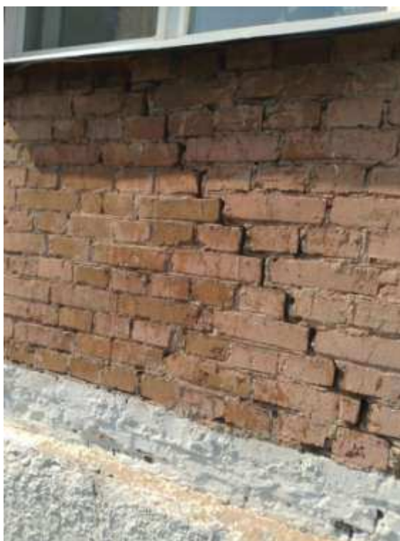
Рисунок 6.4 - Трещины стен многоквартирного жилого дома
