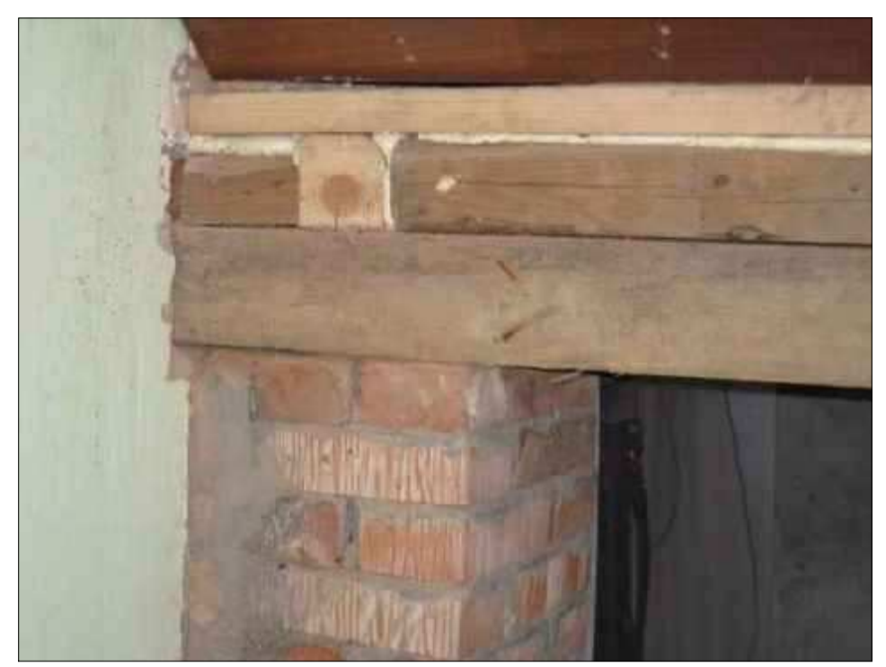
Непосредственное примыкание деревянных конструкций к кирпичной кладке
