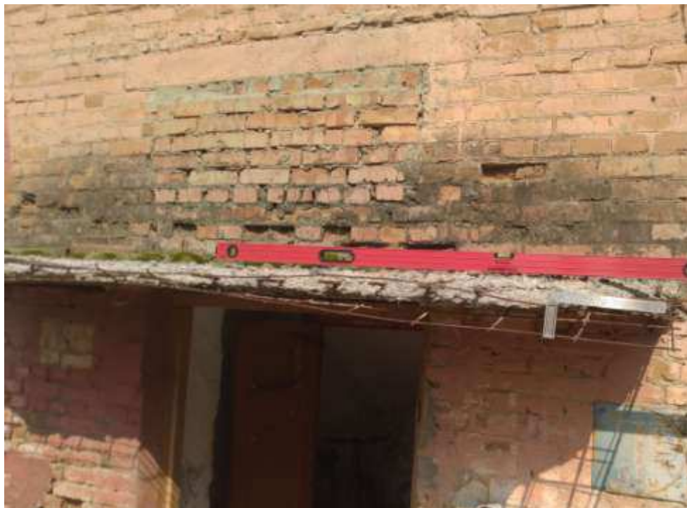
Рисунок 6.5 – Полное разрушение железобетонной плиты козырька с оголением арматурной сетки, разрушение облицовочного кирпича с выпадением отдельных камней
