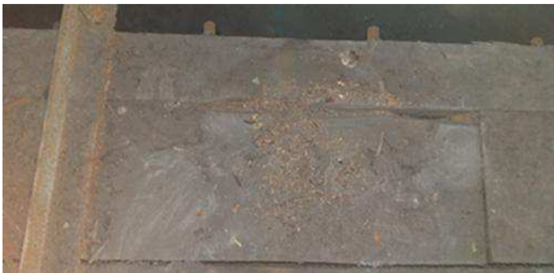
Рисунок 28 - Зазор между стыками элементов нижней фермы (Уменьшение сечения элемента)
