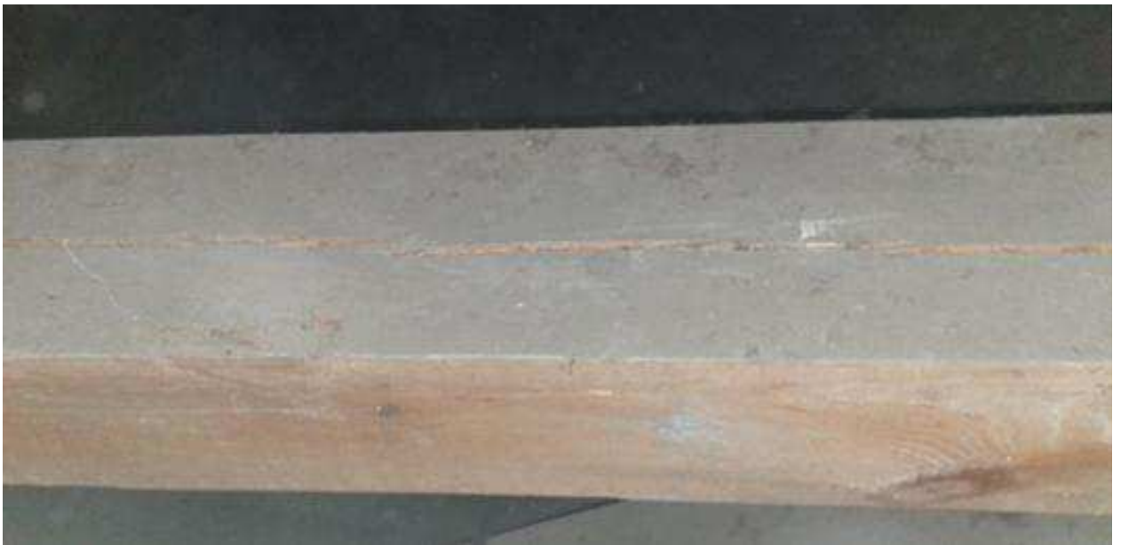
Рисунок 30 - Трещина в раскосе глубиной 32 мм
