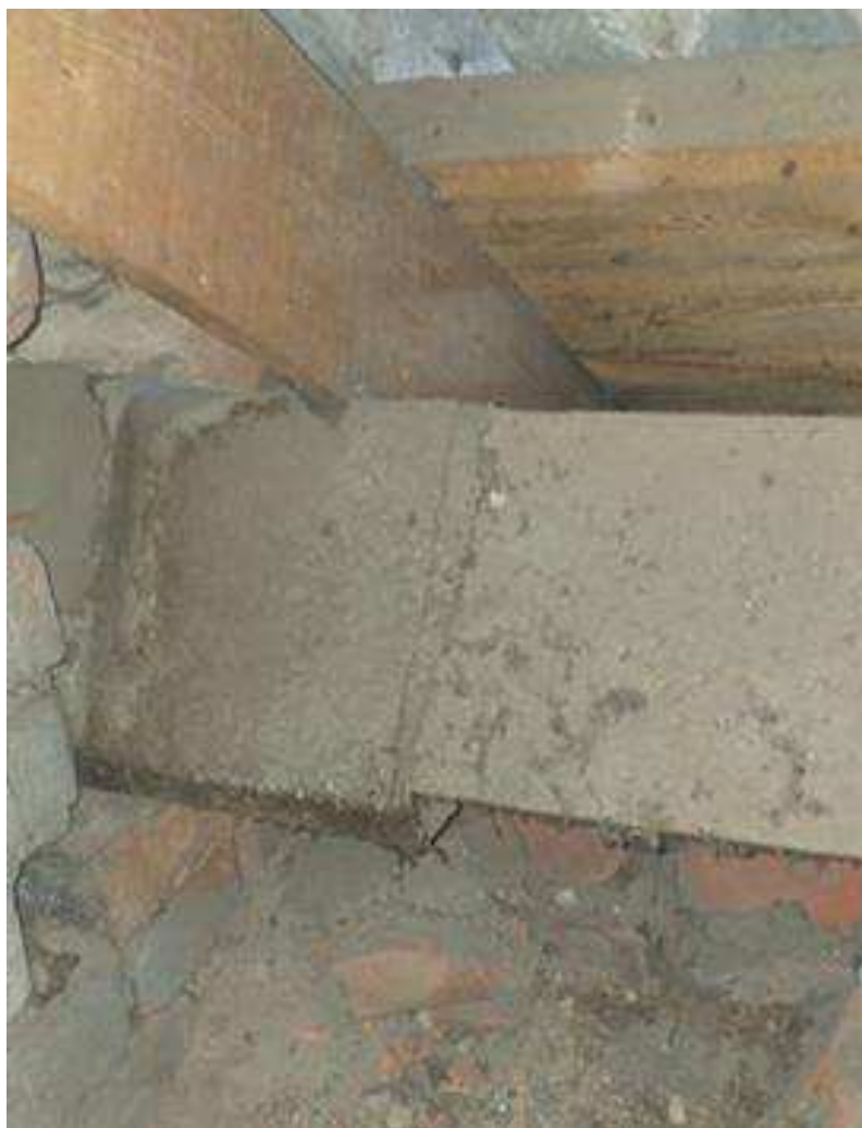
Рисунок 33 - Из-за неудовлетворительного ремонта кровли выявлены многочисленные следы намокания стропильных элементов
