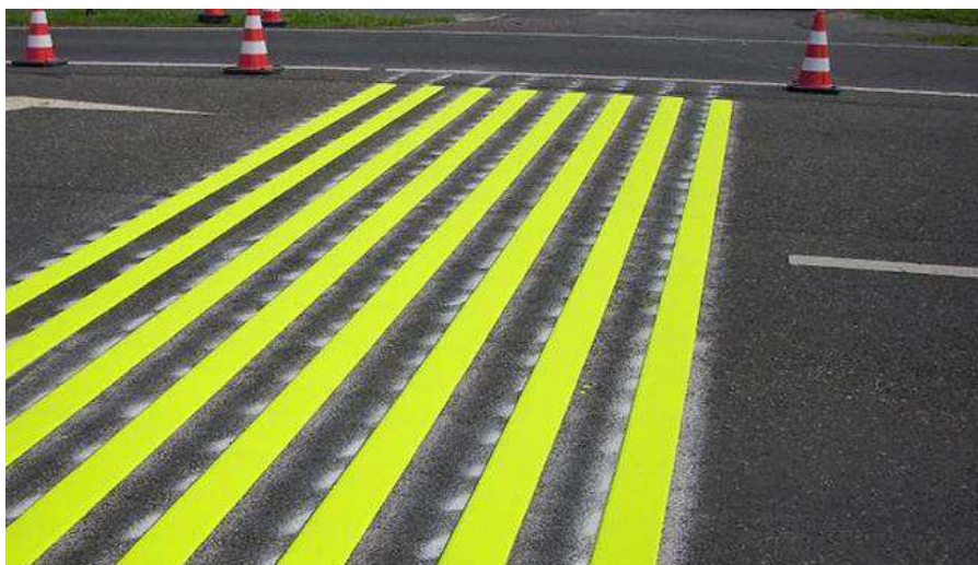
Рисунок 2.3 – Яркие поперечные шумовые полосы на проезжей части автомобильной дороги
